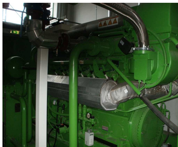
Kogenerators o mocy 525 kW
