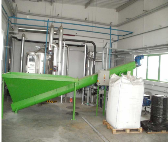
Pomieszczenie do uzdatniania odpadów poubojowych kat II i III
