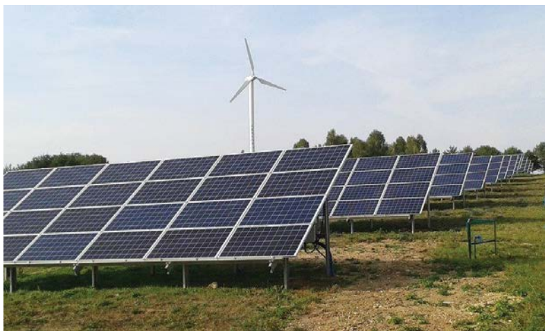
Fot.4. Hybrydowa instalacja złożona z paneli fotowoltaicznych i wiatranka, woj. świętokrzyskie
