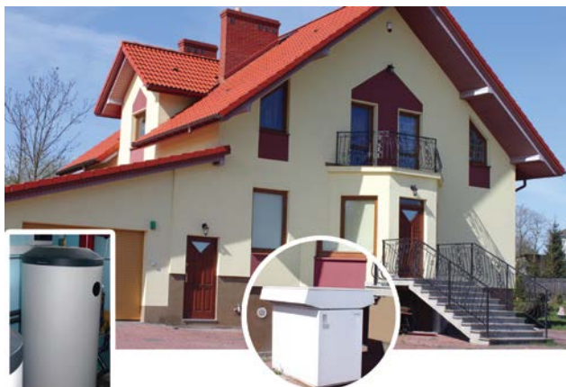
Fot.6. Pompa ciepła do ogrzewania domu mieszkalnego, woj. mazowieckie.
