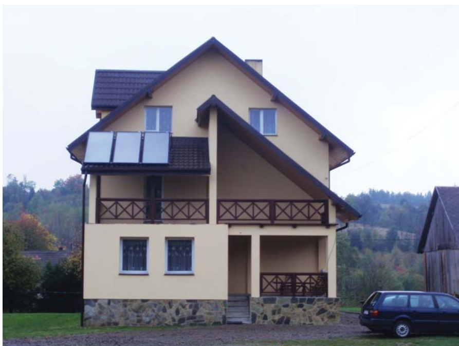
Fot.3. Płaski kolektor słoneczny zamontowany na domu mieszkalnym w woj. lubelskim.
