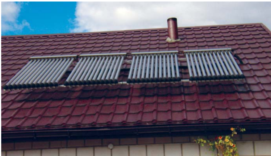
Fot.5. Rurowy kolektor słoneczny do podgrzewania wody użytkowej zamontowany na budynku inwentarskim w woj. mazowieckim.
