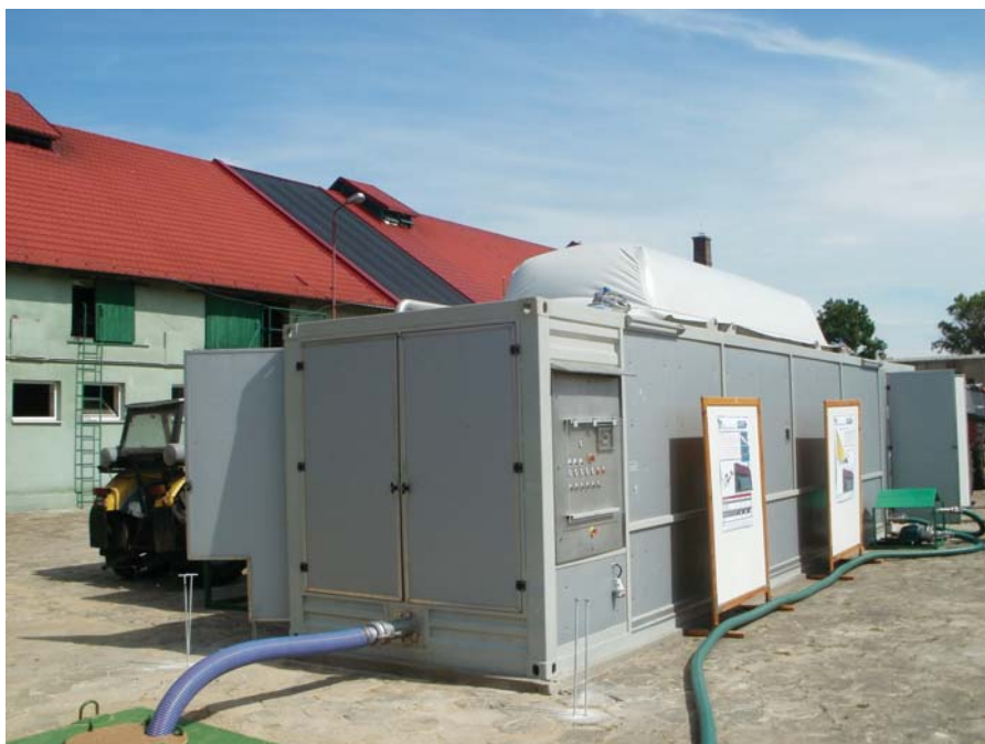
Fot.1. Mikrobiogazownia o mocy 10 kW konstrukcji Instytutu Technologiczno-Przyrodniczego O/Poznań.
